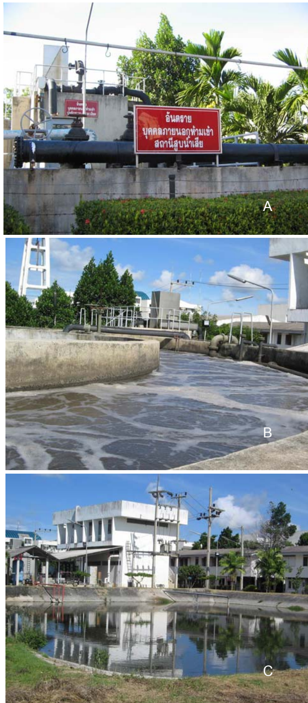
ภาพที่ 3 แสดงภาพถ่ายจุดเก็บตัวอย่างระบบบำบัดน้ำเสียของโรงพยาบาลสงขลา อำเภอเมือง จังหวัดสงขลา แบบตะกอนเร่งชนิด Extended aeration ประกอบด้วย 3 ส่วน คือ น้ำทิ้งดิบที่ยังไม่ผ่านการบำบัด (A) น้ำทิ้งในถังเติมอากาศ (B) และน้ำทิ้งที่ผ่านการบำบัด (C)
